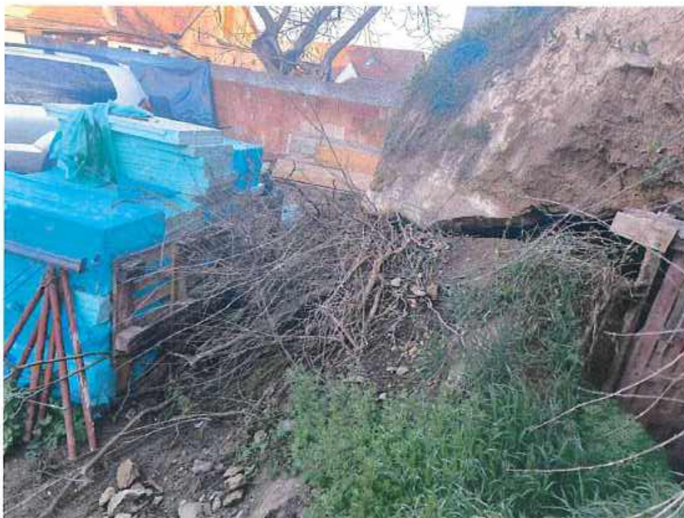
1.kép: A 2026. február 25-i omlás az alsó Arany J. u. 23. lakóingatlan pincéinek lejárátát részben elzárta, a telekvég balesetveszélyessé vált.
